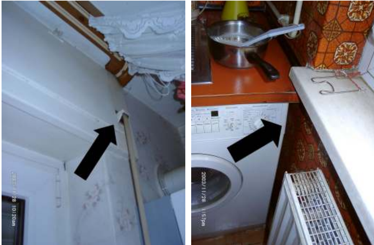
Abbildung 30: Links: Leckagen am Rollladenkasten, insbesondere an der Gurteinführung. Rechts: In der Küche festgestellte Luftströmung durch den Lüftungsstein in der Außenwand.
