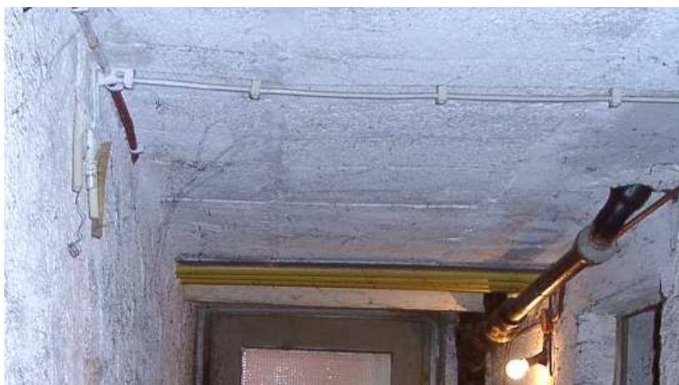
Abbildung 47: Decke Kellerflur in Haus 46 in Richtung Westen unter der rechten EG Wohnung.
