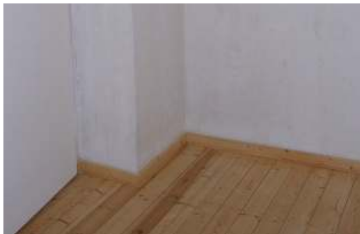
Abbildung 53: Unbenutzter Schornsteinschacht in der Ecke von zwei Innenwänden im hinteren Wohnraum.
