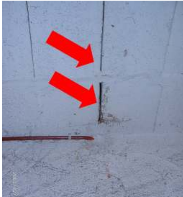
Abbildung 48: Fuge in der Kellerdecke unter EG Wohnung rechts von Haus 46. Detail aus Abbildung 47, unter anderer Perspektive aufgenommen.
