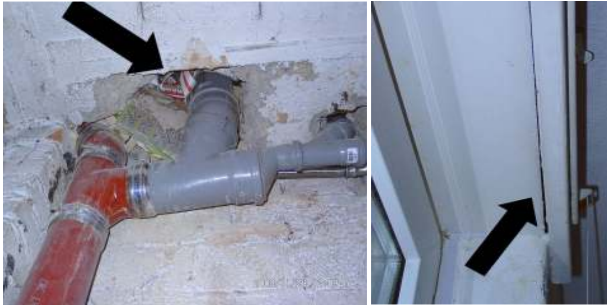
Abbildung 28: Links : Leckagen am Abwasserrohr einer EG-Wohnung (vom Kellerflur gesehen). Der Bereich war mit Zeitungspapier ausgestopft. Rechts : Leckage in einer Wohnung am Rolladenkasten.
