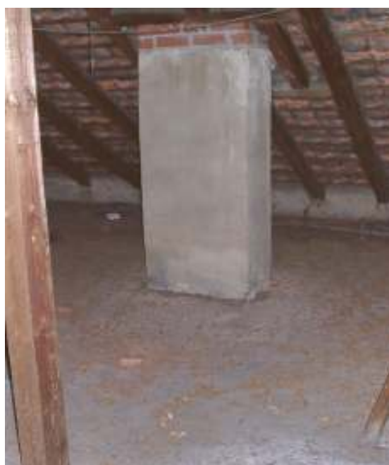
Abbildung 54: Dachboden von Haus 46 mit oberster Geschossdecke, Kaminschacht und von unten offenem Ziegeldach.
