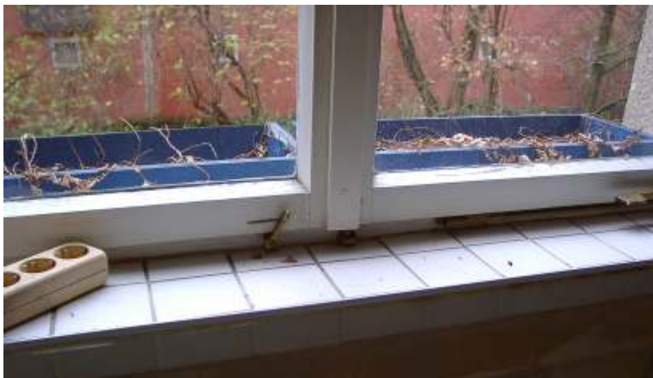
Abbildung 29: Undichtiges Fenster in einer Wohnung
