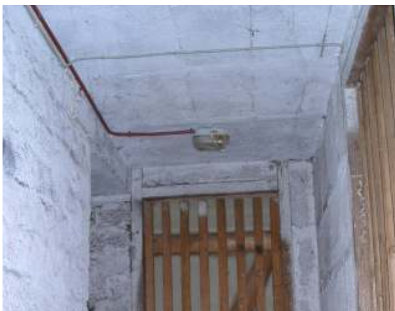
Abbildung 45: Decke Kellerflur in Haus 46 in Richtung Westen unter der linken EG Wohnung.
