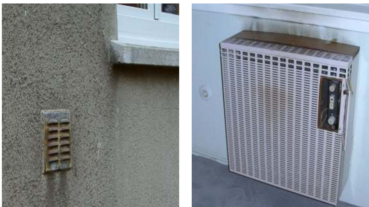
Abbildung 26: Lüftungsgitter für Küchenbelüftung und Einzelraum Gasofen mit Abgasrohr nach außen. Deutlich zu erkennen ist der Ruß- und Staubniederschlag an der kalten Innenoberfläche der Außenwand.
