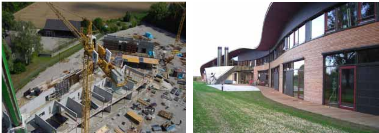
Abbildung 19: Montessori-Schule in Aufkirchen, Walbrunn Grotz Vallentin Architekten, Bockhorn. Links: Stahlbetonskelett. Rechts: Außenwand in Holzleichtbau. [AkkP 33] (Fotos: G. Vallentin)
