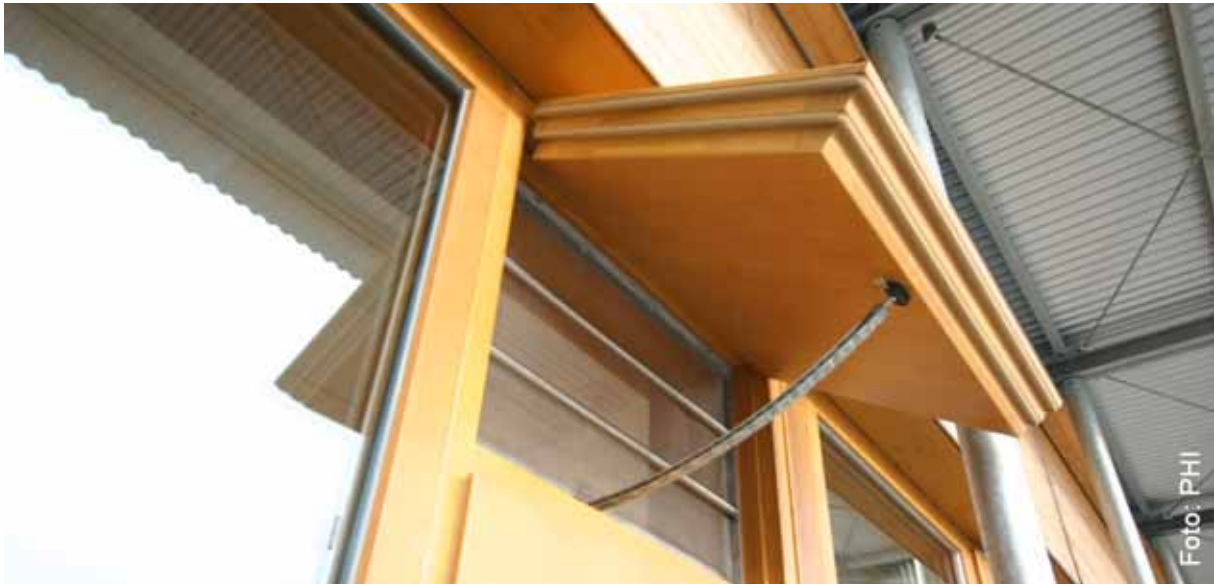
Abbildung 109: Nachtlüftungsklappe einer Kindertagesstätte. Der Kettenantrieb ermöglicht einen großen Öffnungswinkel. Die nach außen öffnende Klappe verhindert das Eindringen von Regen, die Stäbe stellen einen wirksamen Einbruchschutz dar und das dahinterliegende Netz sichert den Insektenschutz. Kindertagesstätte in Frankfurt Schwanheim / Architektur: sdks, Darmstadt
