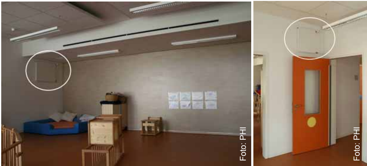
Abbildung 85: Anordnung der Heizkörper in einer Passivhaus-Kindertagesstätte (Goldstein) in Frankfurt. Die Anordnung der Heizfläche spielt keine große Rolle für deren Funktion. Weitere praktische Abwägungen können bei der Entscheidung in den Vordergrund treten.
