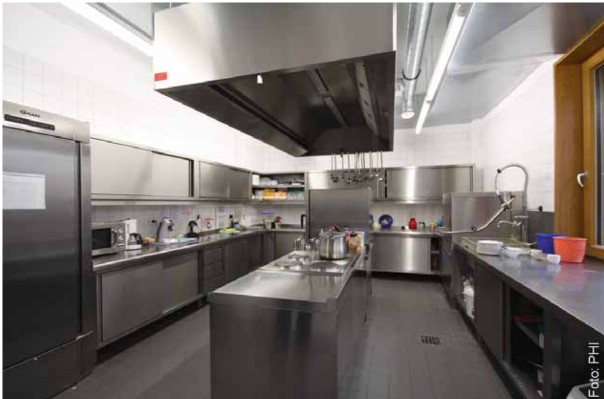
Abbildung 80: Küche einer Kindertagesstätte in Frankfurt (Schwanheim). Küchenlüftung mit Induktionshaube.
