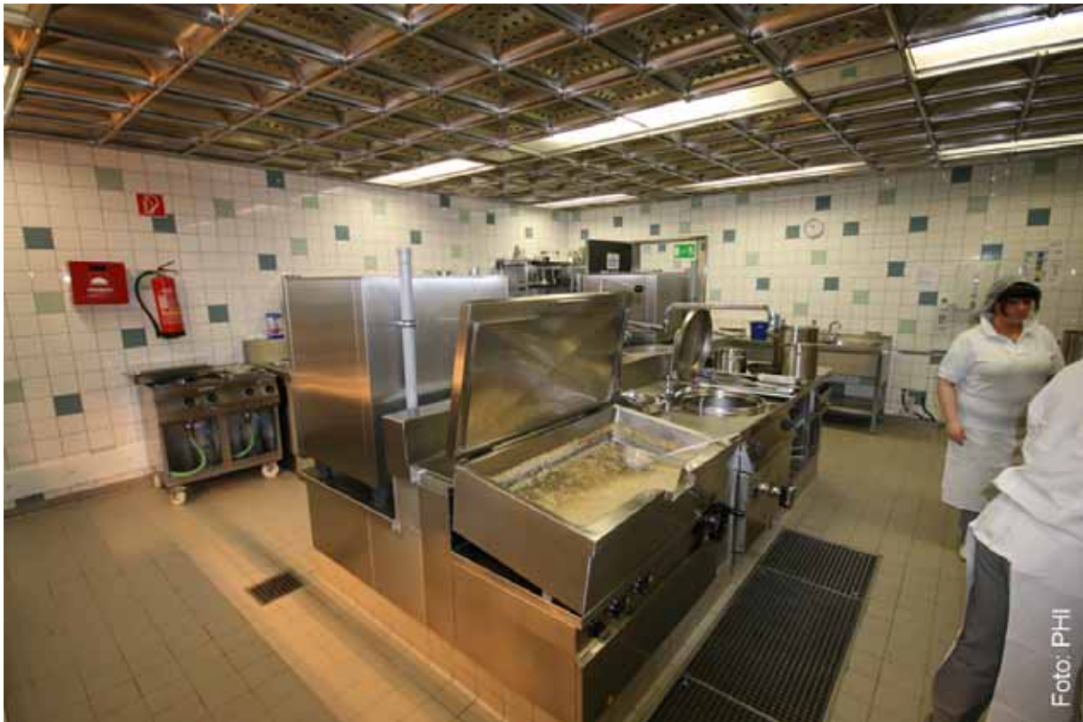
Abbildung 79: Küche in einer Grundschule in Frankfurt (Riedberg). Küchenlüftung mit Wärmerückgewinnung.
