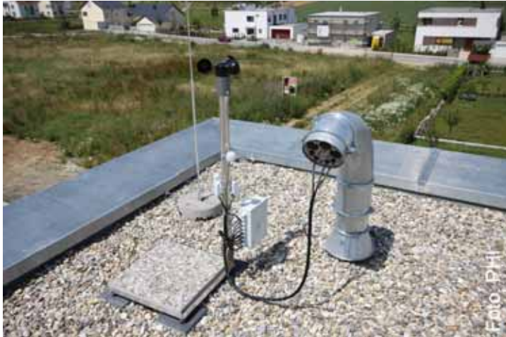
Abbildung 105: Wetterstation für Sonnenschutz-Steuerung. Sonnenschutzanlagen müssen über eine Wetterstation gesteuert werden. Der variable Sonnenschutz sollte für Windgeschwindigkeiten von mindestens 13 m/s ausgelegt sein [Linder 2009].
