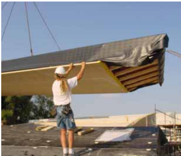
Abbildung 30: Montage der Holzbau-Dachelemente der Montessori-Schule in Aufkirchen. Auf eine tragende Unterkonstruktion wurde zugunsten großer Spannweiten und hoher Träger verzichtet. Durch entsprechend starke Dämmung zwischen den Trägern wurde so der U-Wert von 0,10 W/(m 2 K) sehr kostengünstig erreicht [Vallentin 2006]. Architektur: Walbrunn Grotz Vallentin, Bockhorn. (Foto: G. Vallentin)
