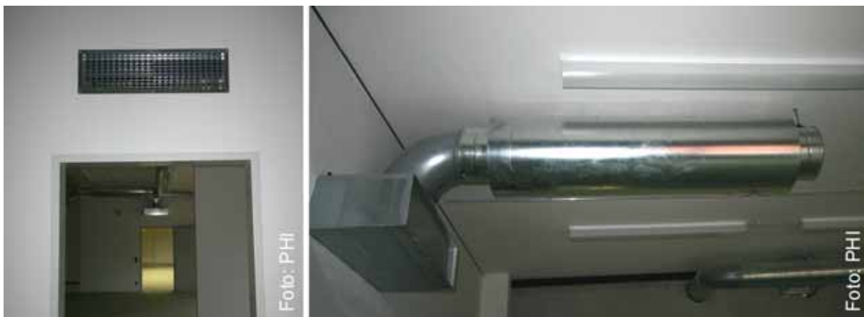
Abbildung 64: Überströmung vom Fachraum in den Vorbereitungsraum. Das schalldämpfende Überströmelement wurde aus Kanalstücken und Kanaleinbauteilen zusammengestellt. Schul-Pavillon Walldorf / Architektur: IB W. Herrmann, Walldorf / Haustechnik: Gadow + Graeske, Walldorf.
