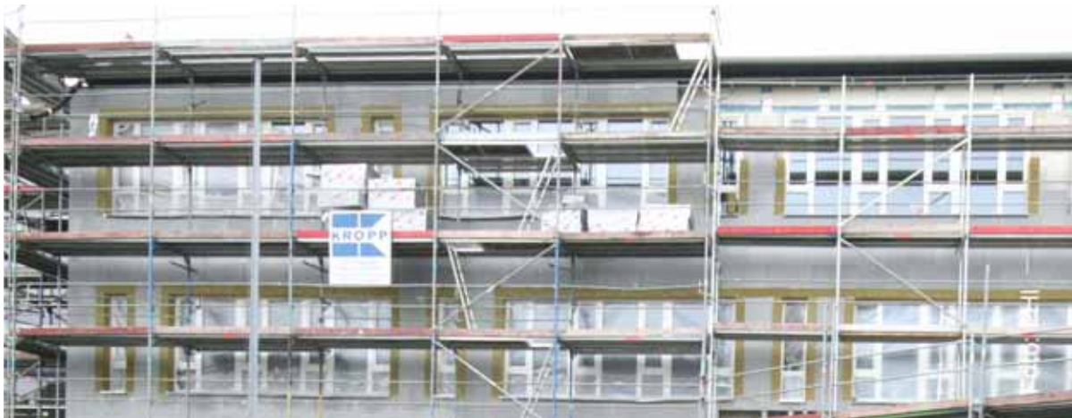
Abbildung 11: Albert-Schweizer-Gymnasium Alsfeld, Brandbarriere. Architektur: BLFP, Friedberg
