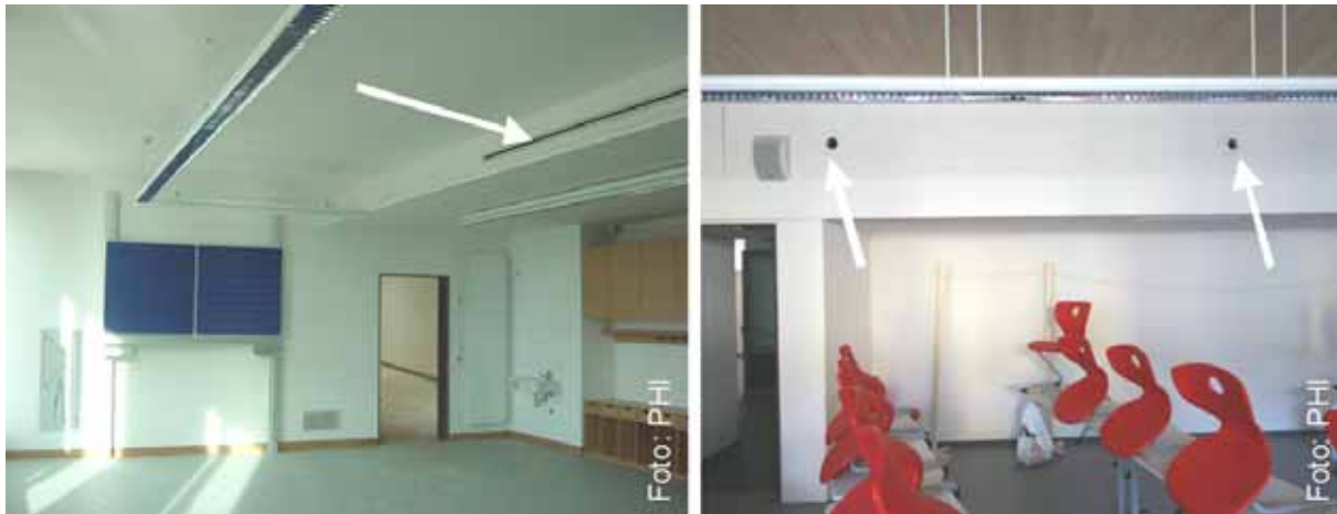
Abbildung 69: Schlitzauslässe (Bild links) haben sich gut bewährt. Strahlauslässe (Bild rechts) sollten nicht mit zu hohen Luftgeschwindigkeiten betrieben werden (besser mehrere Auslässe setzen), damit keine Zegerscheinungen entstehen. Passivhaus-Schule Frankfurt (links): Architektur: 4a, Stuttgart / Haustechnik: ICRZ Ing. Cons. Ruth + Zimmermann, Neuenhagen Passivhaus-Schule Alsfeld (rechts): Architektur: BLFP, Friedberg / Haustechnik: Neuplan, Gießen.
