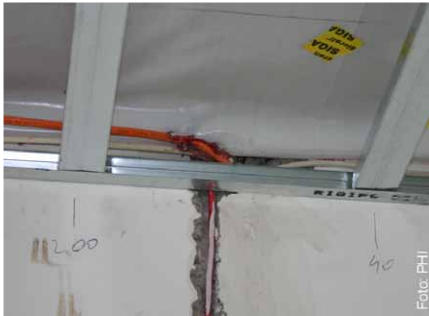
Abbildung 39: Die Kabelführung in der Wand ist unverputzt, obwohl der Dachanschluss mittels Folienverklebung bereits hergestellt wurde. [Peper 2004]
