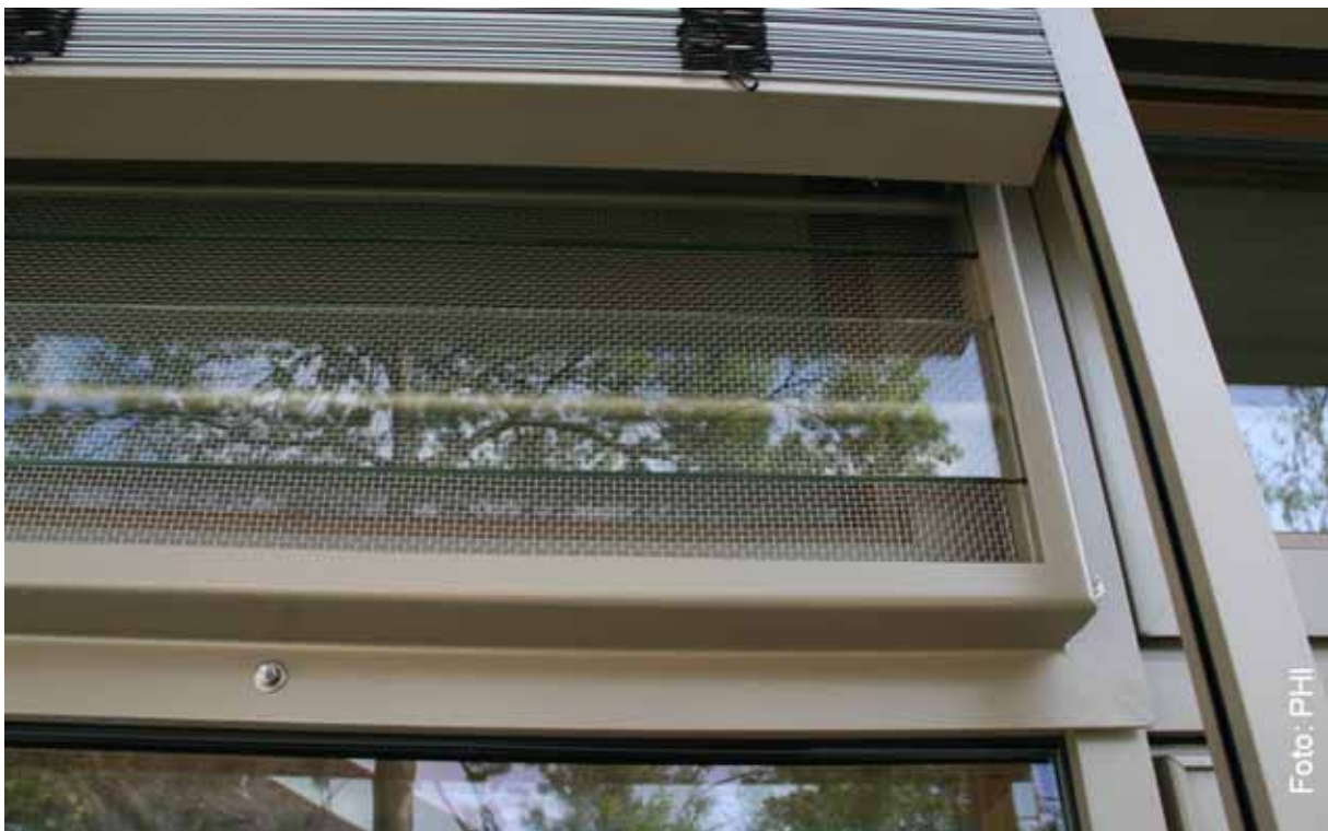
Abbildung 110: Detail einer Lüftungsklappe. Glaslamellen und ein Drahtgewebe stellen den Einbruch- und Insektenschutz sicher. Kindertagesstätte Goldstein (Frankfurt), Architektur: AS&P, Frankfurt
